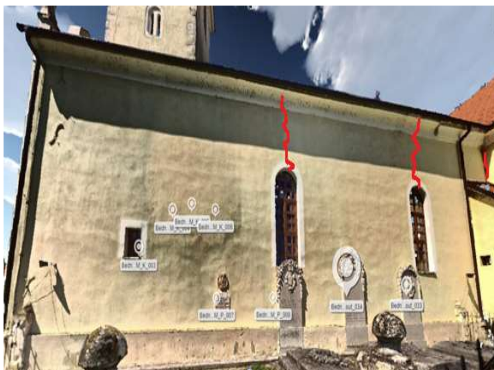
Fotografija 16 Južna fasada ima manje pukotina od sjeverne
